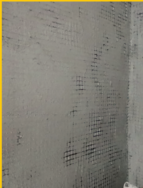
Posa della malta tecnica MX-C 25 Muratura e della rete in carbonio C-MESH 42/42.
