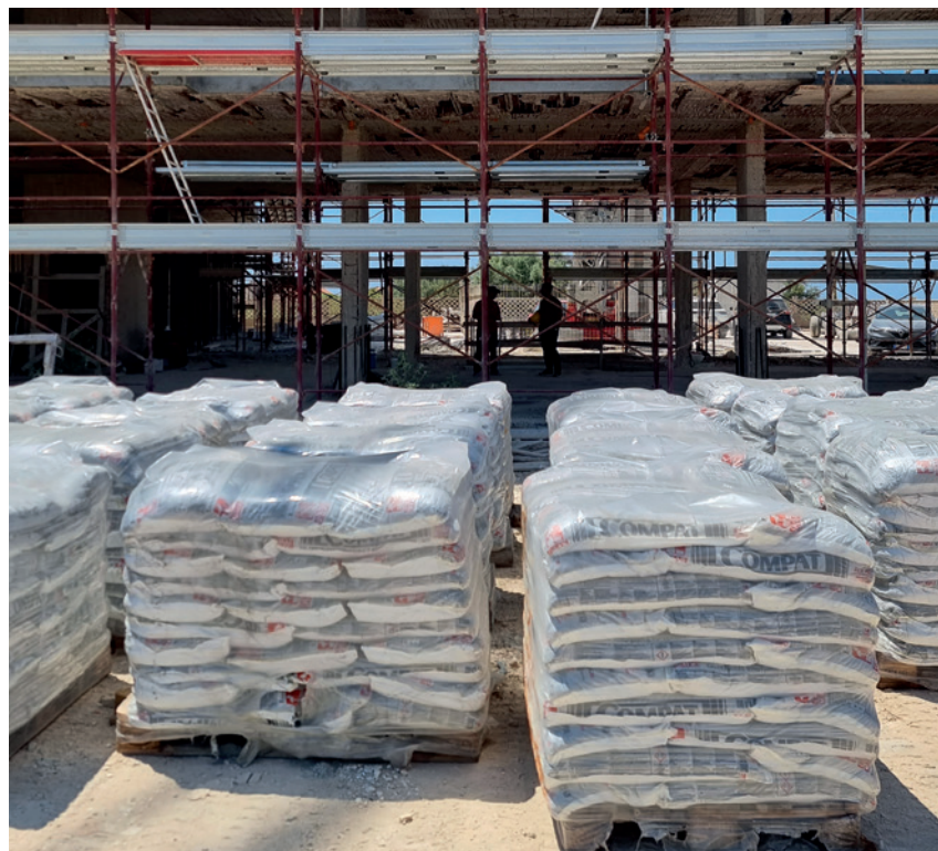
Il ringrosso delle strutture in calcestruzzo armato è stato realizzato attraverso la tecnica del Jacketing utilizzando il calcestruzzo Compat Gras Calce.
