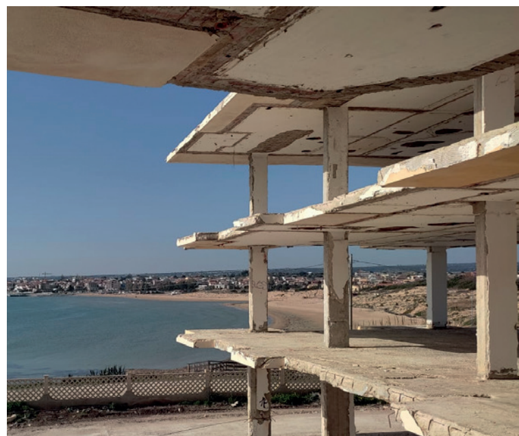
Stato di fatto della struttura in calcestruzzo armato degli anni '70 da riqualificare.
