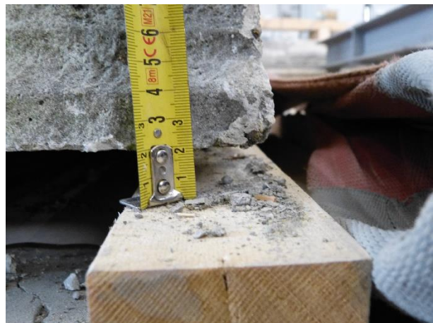
Figura 89 Rilievo del sollevamento dello spigolo destro del travetto 1
