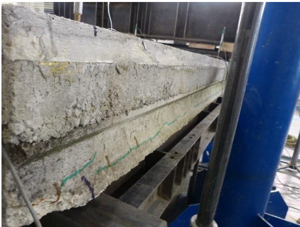
Figura 169 Condizioni del travetto 1 ad inizio prova (in verde vengono segnate le fessure preesistenti)
