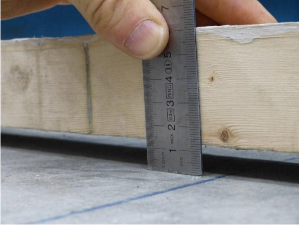
Figura 90 Dettaglio della perdita di planarità
