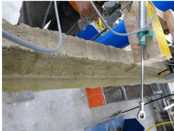
Figura 26 Particolare della fessura longitudinale all'estradosso del travetto
