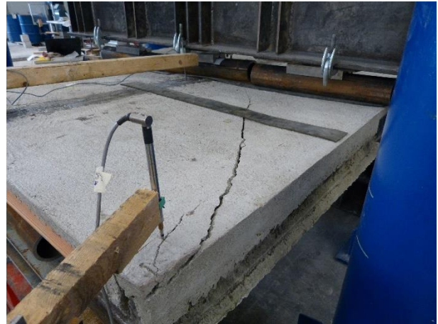
Figura 137 Formazione della fessura all'intradosso a seguito del collasso differenziale dei travetti
