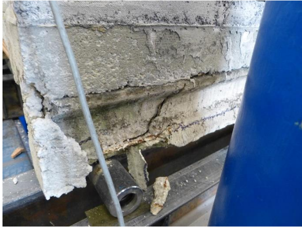
Figura 80 Condizioni dell'appoggio sinistro del travetto 1 a fine prova
