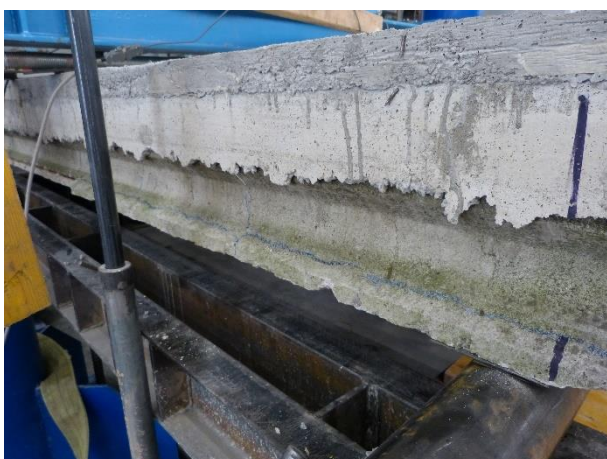
Figura 109 Condizioni generali dei travetti ad inizio prova (in blu il rilievo delle fessure)
