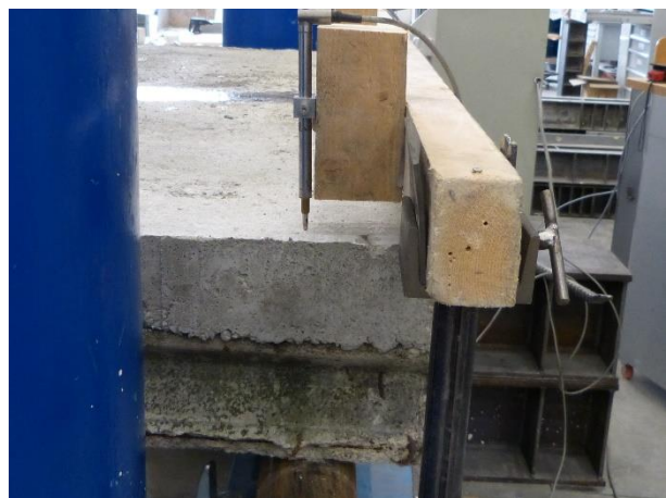
Figura 122 Vista del campione in prossimità degli appoggi con evidente espulsione di copriferro
