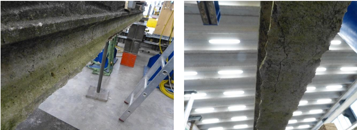
Figura 33 Condizioni del travetto prima della prova di flessione, con dettaglio del quadro fessurativo all'intradosso del travetto
