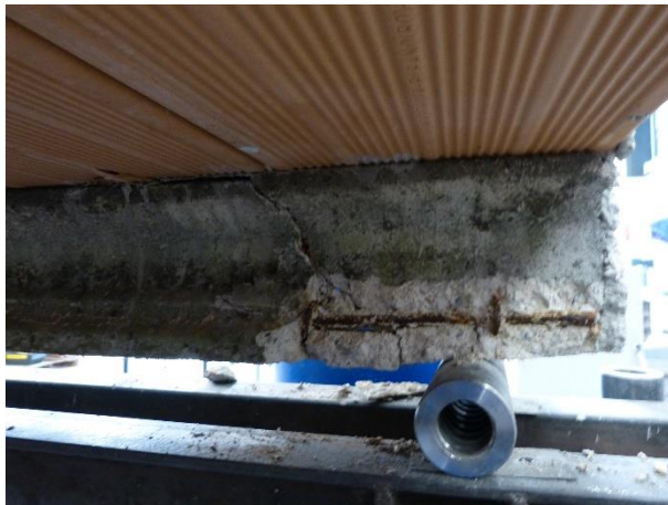
Figura 82 Condizioni dell'appoggio destro del travetto 3 a fine prova
