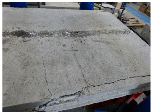
Figura 135 Condizioni dell'estradosso del solaio a fine prova
