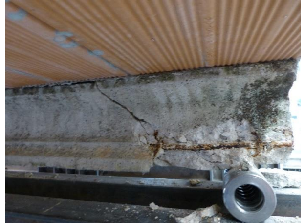
Figura 81 Condizioni dell'appoggio destro del travetto 2 a fine prova
