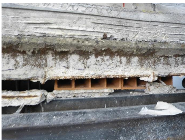
Figura 84 Dettaglio delle condizioni del travetto 3 con rottura del copriferro e perdita dell'appoggio della pignatta
