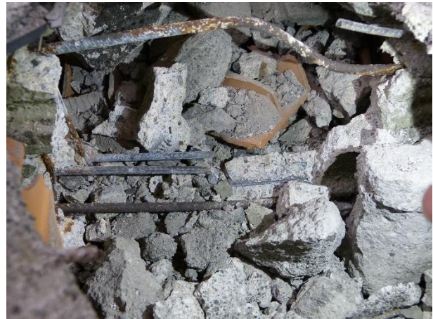
Figura 184 Dettaglio osservabile dopo un accurata demolizione delle barre \phi 8 del travetto 2 portate a rottura durante la prova
