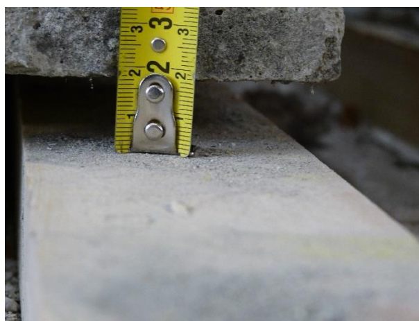
Figura 154 Rilievo del sollevamento dello spigolo destro del travetto 1
