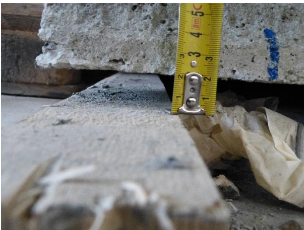
Figura 88 Rilievo del sollevamento dello spigolo sinistro del travetto 1
