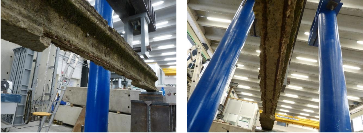
Figura 19 Dettaglio dell'espulsione di copriferro in mezzeria del travetto
