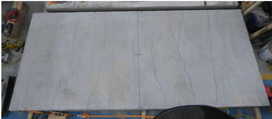
Figura 103 Quadro fessurativo della cappa collaborante prima di iniziare la prova
