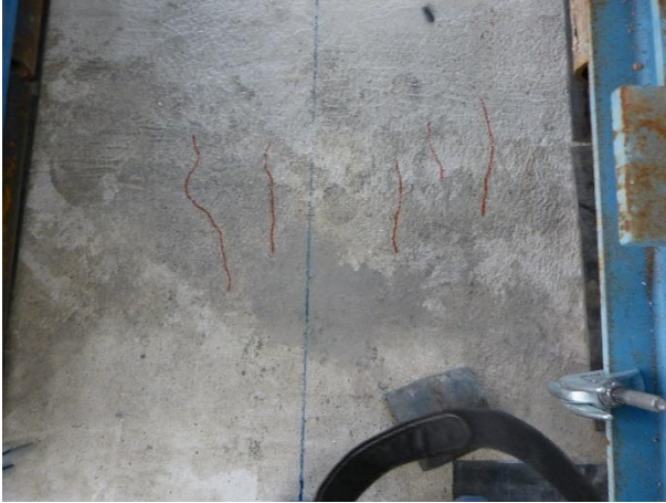
Figura 68 Formazione di un quadro fessurativo perpendicolare alla direzione dei travetti nella cappa
