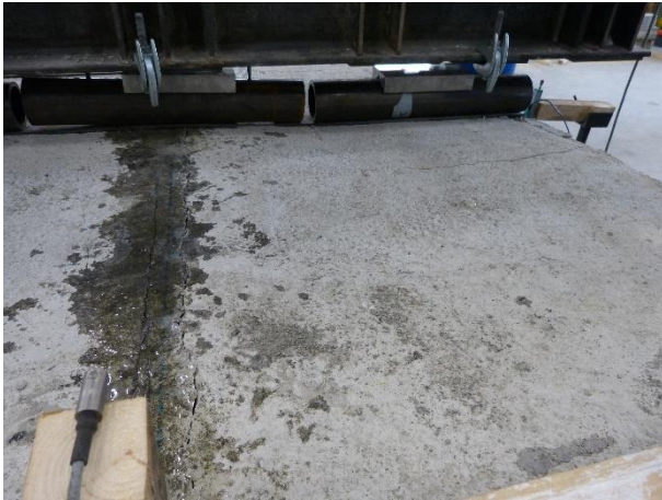
Figura 136 Dettaglio della formazioni di una nuova fessura parallela al travetto a fine prova in posizione esterna alla zona riparata
