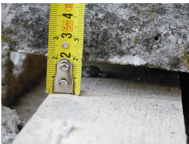
Figura 153 Rilievo del sollevamento dello spigolo sinistro del travetto 1
