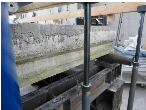
Figura 105 Condizioni dell'appoggio destro del travetto 1 (in blu il rilievo delle fessure)
