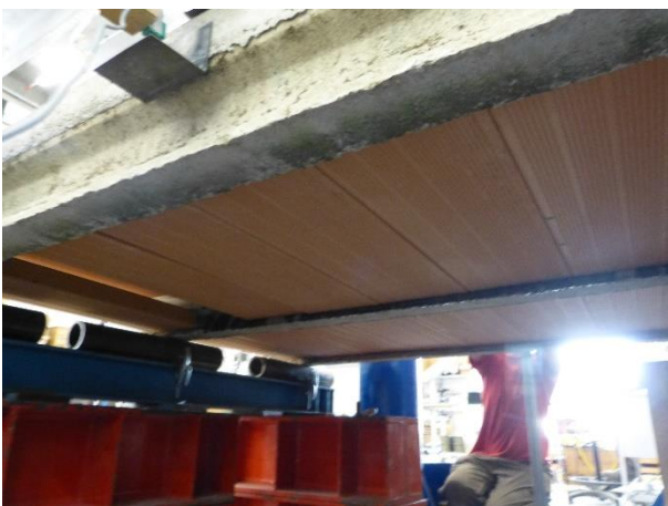
Figura 123 Vista da sotto del solaio in cui si osserva la presenza delle tavole e dell'intradosso dei travetti
