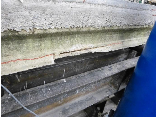
Figura 155 Condizioni dei travetti a inizio prova
