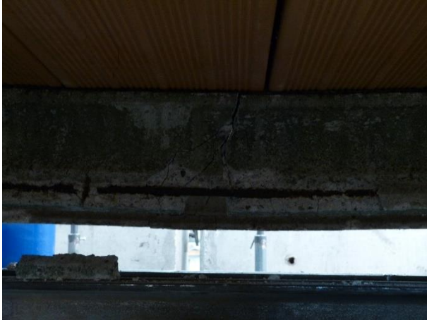
Figura 181 Quadro fessurativo in mezzeria del travetto 2
