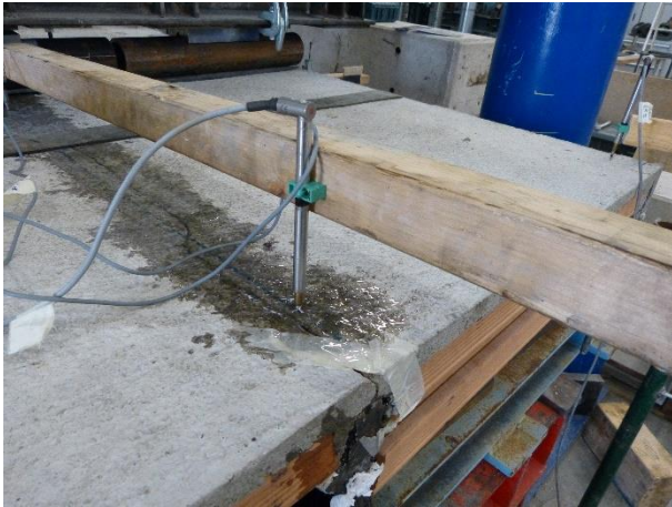
Figura 125 Dettaglio della fessura formata in fase di trasporto del provino e successivamente riparata con resina epossidica bicomponente
